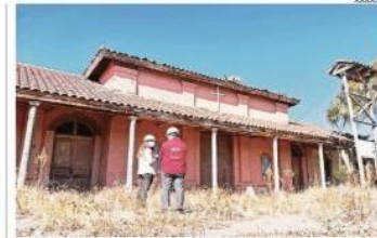
TRAS EL TERREMOTO, SUFRIÓ DAÑOS EN SU ESTRUCTURA.
